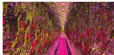
ТК ЛипецкАгро. Замена половины натриевых светильников на LED светильники 1000 Кт на площади 5,7 Га
